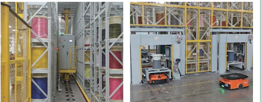
堆垛机叉取出库 AGV对接自动搬运
