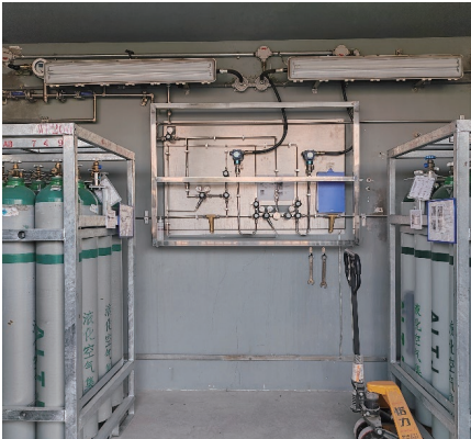
混合气体供应站
