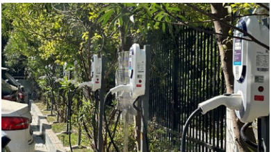
铁松厂区新能源充电桩
