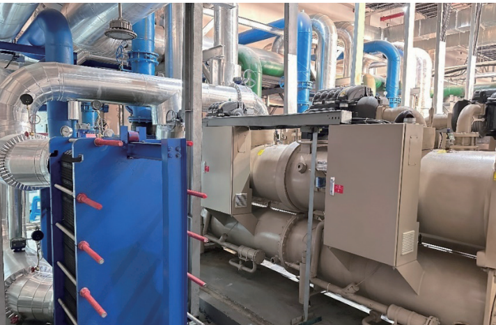
空调板式换热器装置
